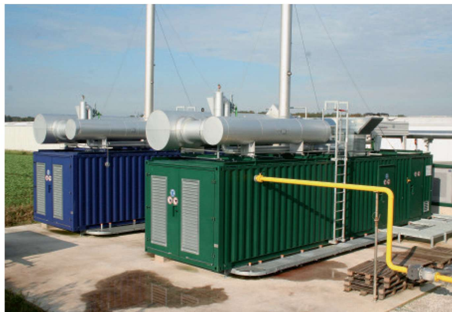
Die beiden gasbetriebenen Blockheizkraftwerke liefern Strom und Wärme
